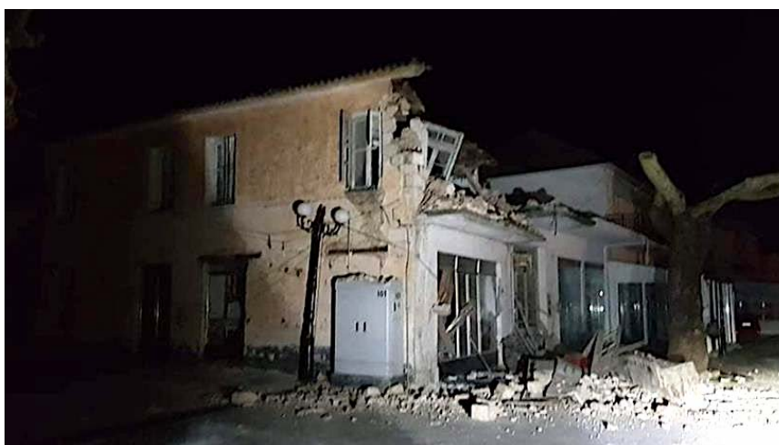
Εικόνα 1. Ανατροπή τοιχοποιίας ορόφου σε κτίριο από φέρουσα τοιχοποιία (πηγή Flash.gr).
