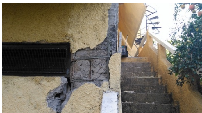
Εικόνα 6.28. Λειτουργία κοντού στύλου και έντονη διαγώνια ρηγμάτωση (κατακερματισμός) του σκυροδέματος.
