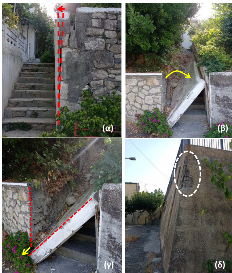
Εικόνα 5.3 Χωριό Μελέσες: (α) Οριζόντια μετακίνηση λιθόκτιστου τοίχου αντιστήριξης (β-γ) Πλήρης ανατροπή λιθόκτιστου τοίχου αντιστήριξης μικρού ύψους (δ) Τοπική αποφλείωση σκυροδέματος και αποκάλυψη οπλισμού σε γωνιακό τοίχο οπλισμένου σκυροδέματος.
