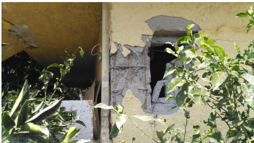
Εικόνα 6.26. Τοπική αποφλοίωση της επικάλυψης σκυροδέματος σε κτήριο από οπλισμένο σκυρόδεμα.
