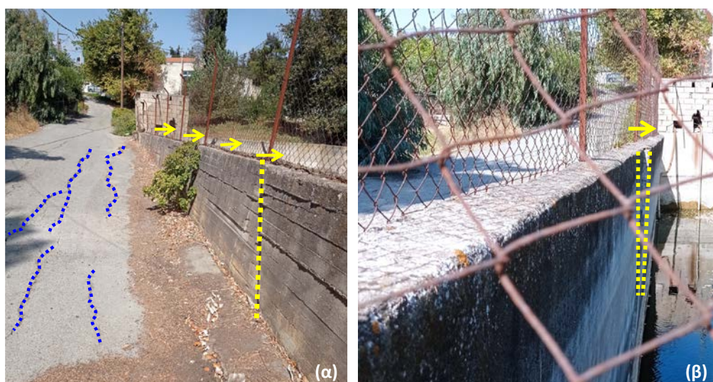
Εικόνα 5.6 Αστοχία τοίχου αντιστήριξης από σπλισμένο σκυρόδεμα στο χωριό Μουσουτά και επακόλουθες ρηγματώσεις στον αντιστηριζόμενο δρόμο.
