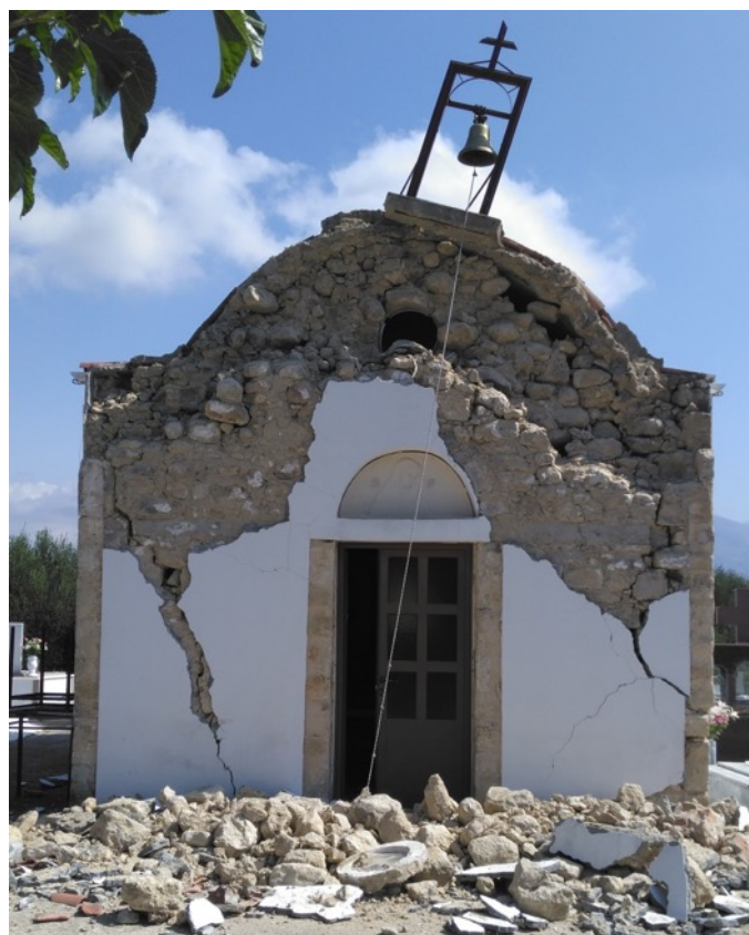
Εικόνα 6.18. Μερική κατάρρευση με εκτός επιπέδου πτώση της εξωτερικής παρειάς δίστρωτης λιθοδομής σε Ναό στην Μουσουτά.
