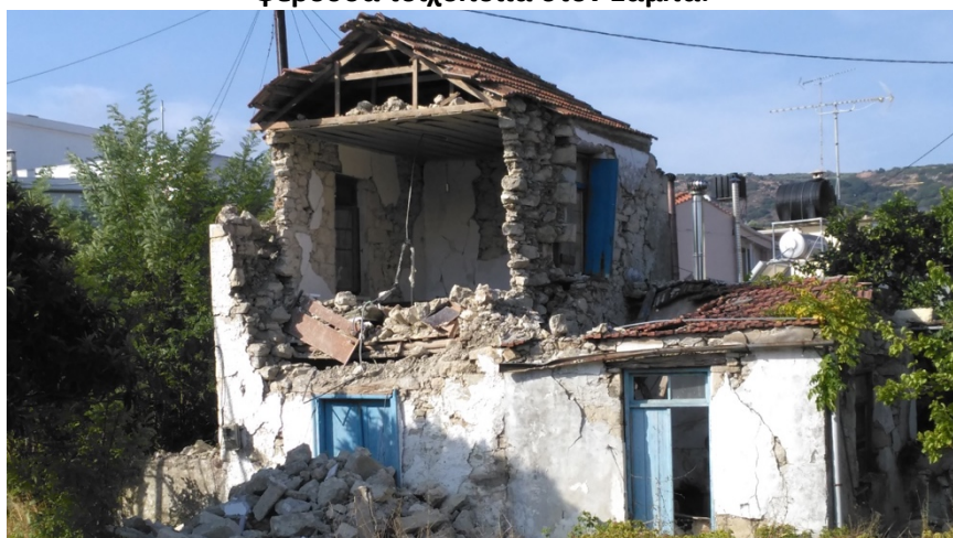
Εικόνα 6.6. Μερική κατάρρευση στον όροφο διώροφου κτηρίου από φέρουσα λιθοδομή.
