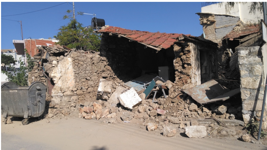
Εικόνα 6.7. Μερική κατάρρευση σε οίκημα από φέρουσα τοιχοποιία στο Αρκαλοχώρι.
