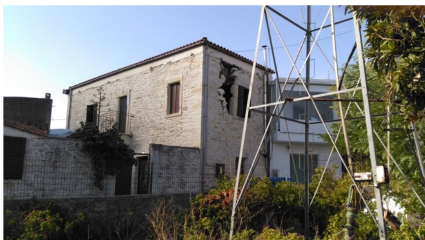
Εικόνα 6.11. Τοπική κατάρρευση μέρους λιθοδομής σε κτήριο από φέρουσα τοιχοποιία με επιμελημένη κατασκευή των λιθοδομών.
