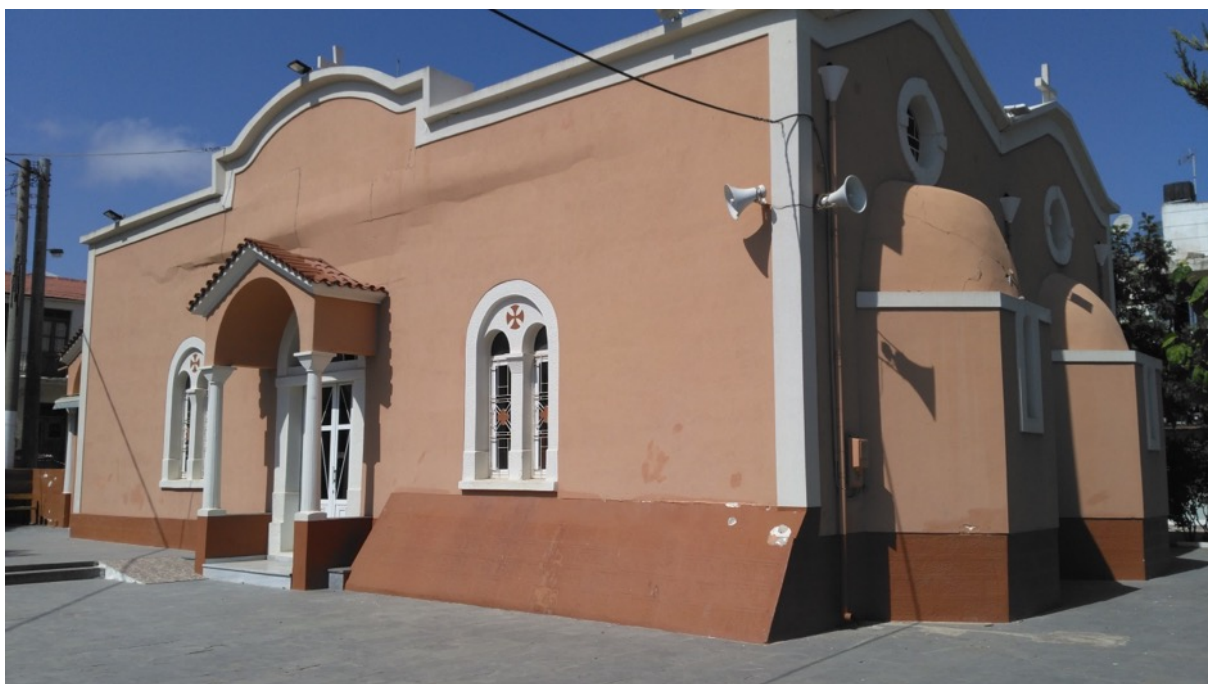
Εικόνα 6.12. Τριχοειδείς ρηγματώσεις στην Ανατολική λιθοδομή (Ιερό) σε Ναό στο Αρκαλοχώρι.
