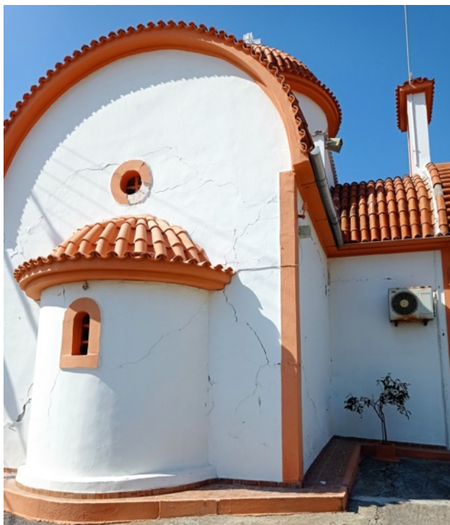
Εικόνα 6.17. Εκτενής ρηγμάτωση στην Ανατολική λιθοδομή σε Ναό στις Κάτω Πουλιές.
