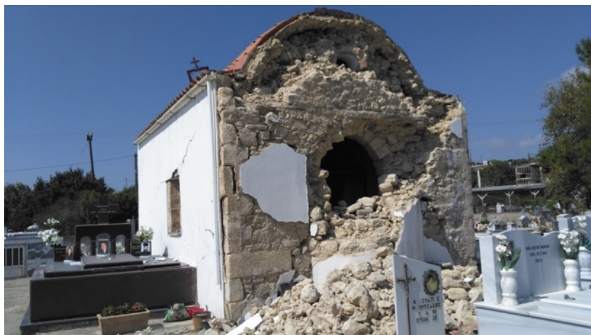
Εικόνα 6.19. Τοπική κατάρρευση λιθοδομής στην Ανατολική λιθοδομή σε Ναό στην Μουσούτα.
