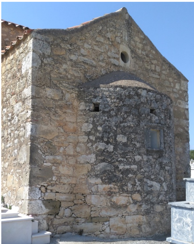
Εικόνα 6.13. Μικρή ρηγμάτωση σε κοιμητηριακό Ναό στην περιοχή έξω από το Αρκαλοχώρι.
