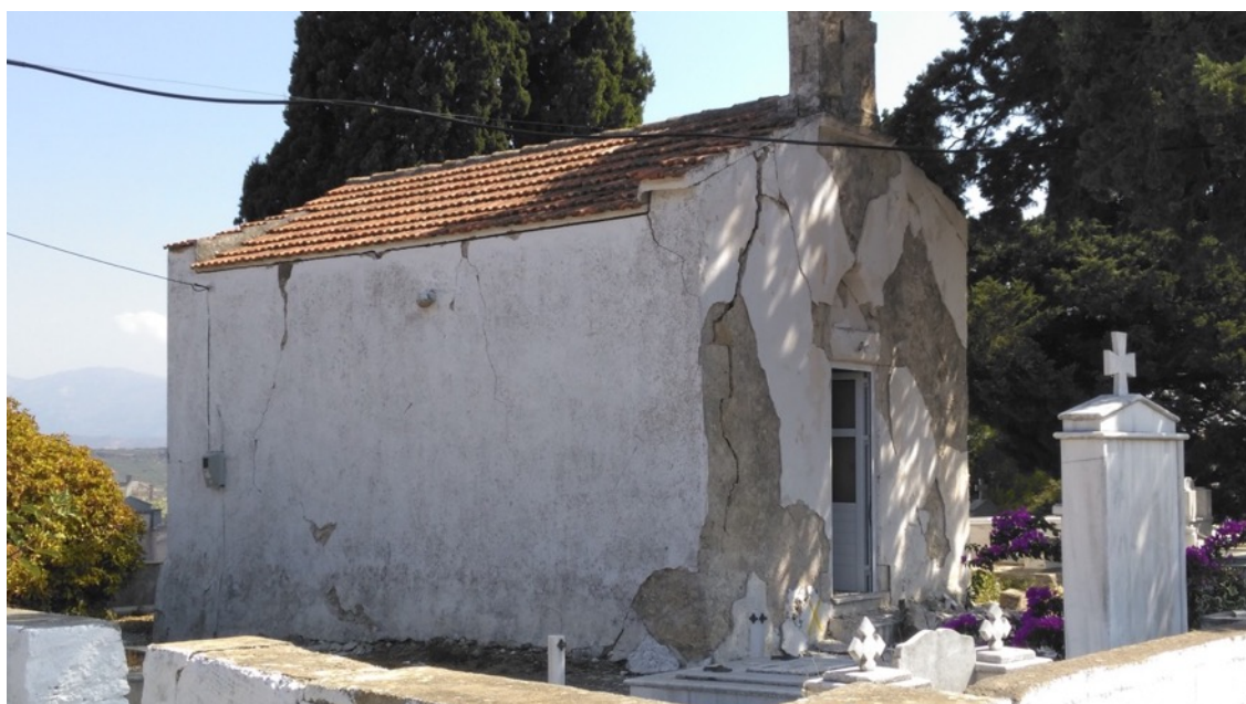
Εικόνα 6.14. Εκτενής ρηγμάτωση σε κοιμητηριακό Ναό στην περιοχή έξω από το Αρκαλοχώρι.
