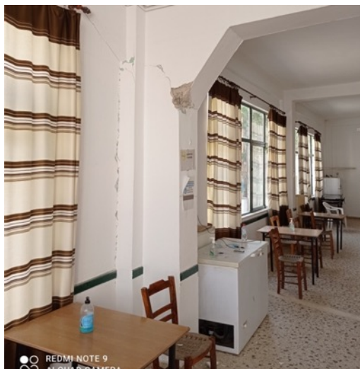
Εικόνα 6.29. Ρηγμάτωση στην κεφαλή υποστυλώματος σε πλαίσιο οπλισμένου σκυροδέματος.
