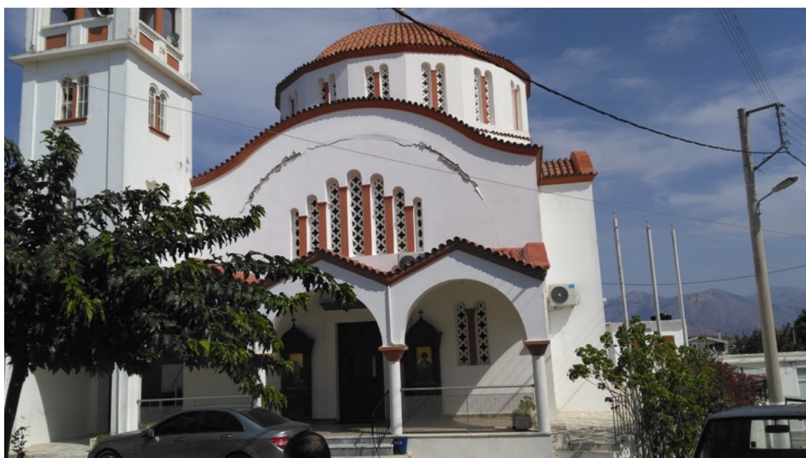
Εικόνα 6.16. Αποκόλληση τοιχοποιίας από τόξο οπλισμένου σκυροδέματος σε Ναό στο Αστρίτσι.
