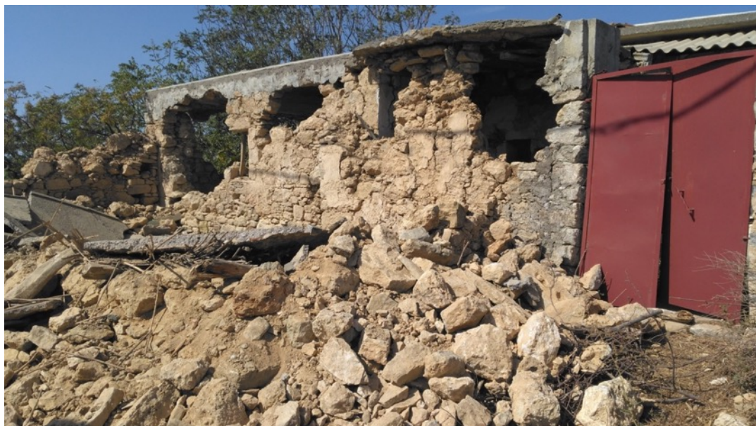
Εικόνα 6.2. Κτήριο με λιθοδομή από ακατέργαστες και ημικατεργασμένες πέτρες και εκτεταμένες καταρρεύσεις.
