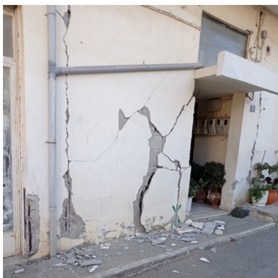
Εικόνα 6.24. Ρηγματώσεις σε στοιχεία σκυροδέματος σε κτήριο στο Αρκαλοχώρι.
