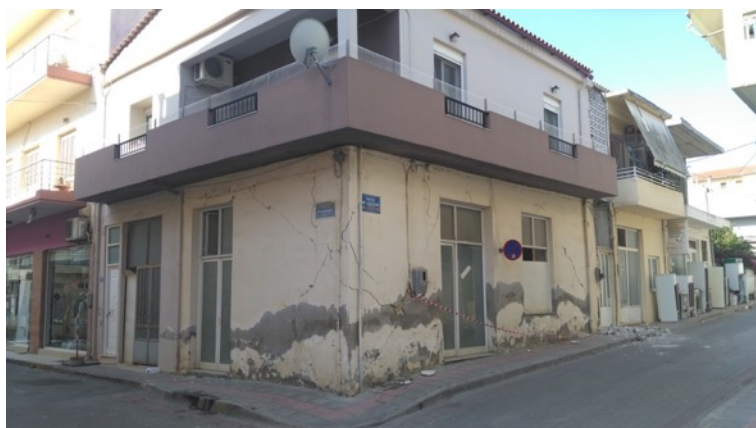
Εικόνα 6.23. Ρηγματώσεις σε τοιχοποιίες και στοιχεία σκυροδέματος σε κτήριο στο Αρκαλοχώρι.
