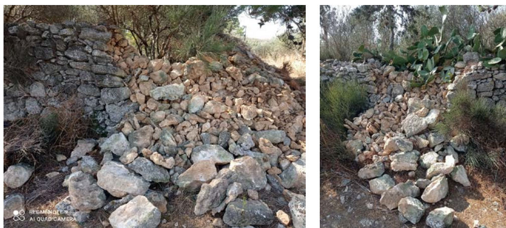
Εικόνα 5.5 Αστοχία λιθόκτιστου τοίχου αντιστήριξης χωρίς συνδετικό κονίαμα (ξεροληθιά) έξω από το νεκροταφείο του χωριού Πατσίδερος.
