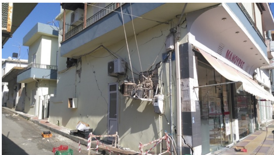
Εικόνα 6.22. Ρηγματώσεις σε τοιχοποιίες πλήρωσης και στα περιβάλλοντα πλαίσια οπλισμένου σκυροδέματος σε κτήριο στο Αρκαλοχώρι.
