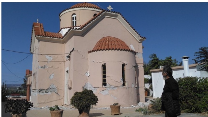
Εικόνα 6.20. Εκτενείς ρηγματώσεις σε λιθοδομές στο Ιερό Ναού στα Ρουσοχώρια.
