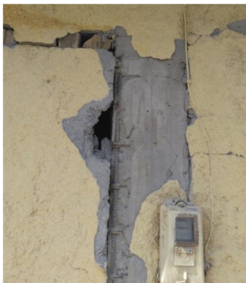
Εικόνα 6.27. Τοπική αποφλοίωση της επικάλυψης σκυροδέματος σε κτήριο από οπλισμένο σκυρόδεμα.
