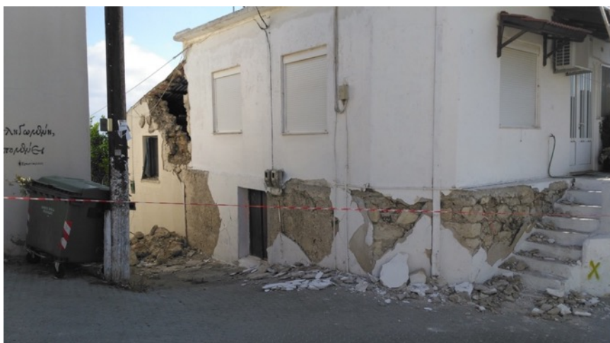
Εικόνα 6.10. Ρηγματώσεις σε στάθμη πλησίον του εδάφους σε κτήριο από φέρουσα λιθοδομή στον Πατσίδερο. Διακρίνονται αλληλοεμπλεκόμενες πέτρες στην ακμή του κτηρίου.
