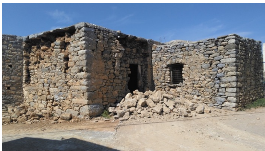
Εικόνα 6.5. Εκτός επιπέδου κατάρρευση της εξωτερικής παρειάς των λιθοδομών σε κτήριο από φέρουσα τοιχοποιία στον Σαμπά.
