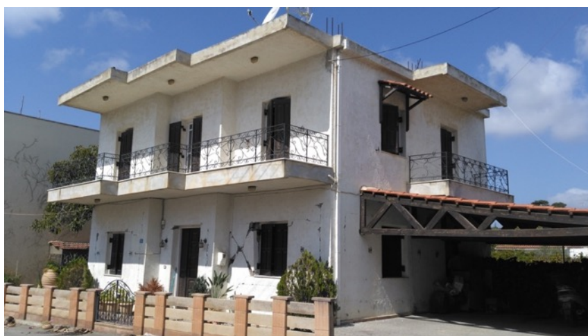
Εικόνα 6.25. Διαγώνιες ρηγματώσεις και αποκολλήσεις σε τοιχοποιίες πλήρωσης σε κτήριο με φέροντα οργανισμό από σπλισμένο σκυρόδεμα.
