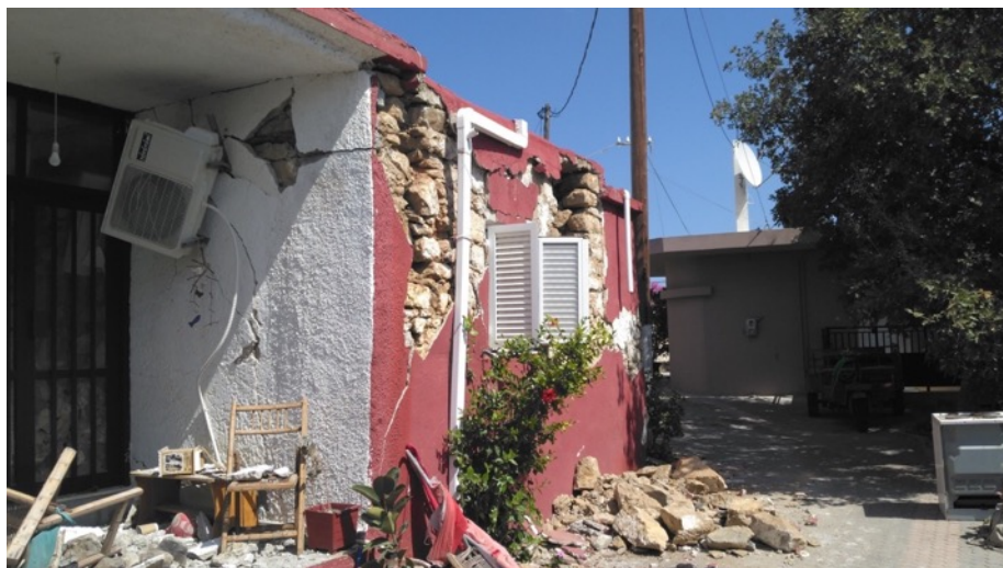
Εικόνα 6.4. Μερική κατάρρευση σε κτήριο με λιθοδομές από ακανόνιστες πέτρες.
