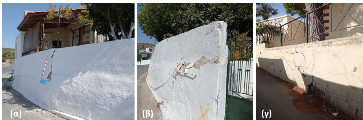
Εικόνα 5.4 (α-β) Τοπικές αστοχίες και ρηγματώσεις σε τοίχο αντιστήριξης στο χωριό Κάτω Πουλιά (γ) Εκτεταμένες ρηγματώσεις τοίχου αντιστήριξης στο χωριό Πατσίδερος.
