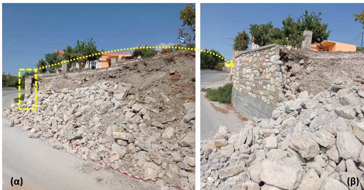
Εικόνα 5.7 Αστοχία λιθόκτιστου τοίχου αντιστήριξης στο χωριό Ζίντα και τοπική κατολίσθηση του αντιστηριζόμενου εδαφικού υλικού.
