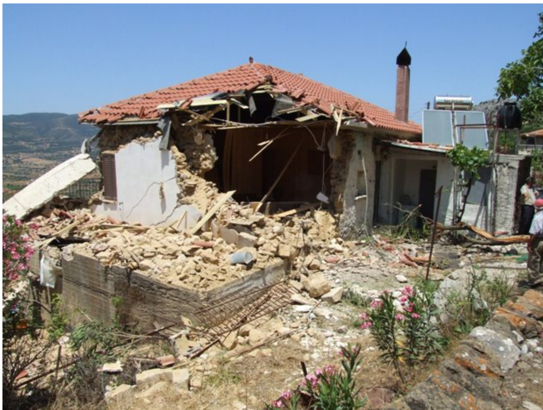
Εικόνα 10. Καταστροφή κτιρίου από πτώση βράχου στον οικισμό Ααντομέρι
