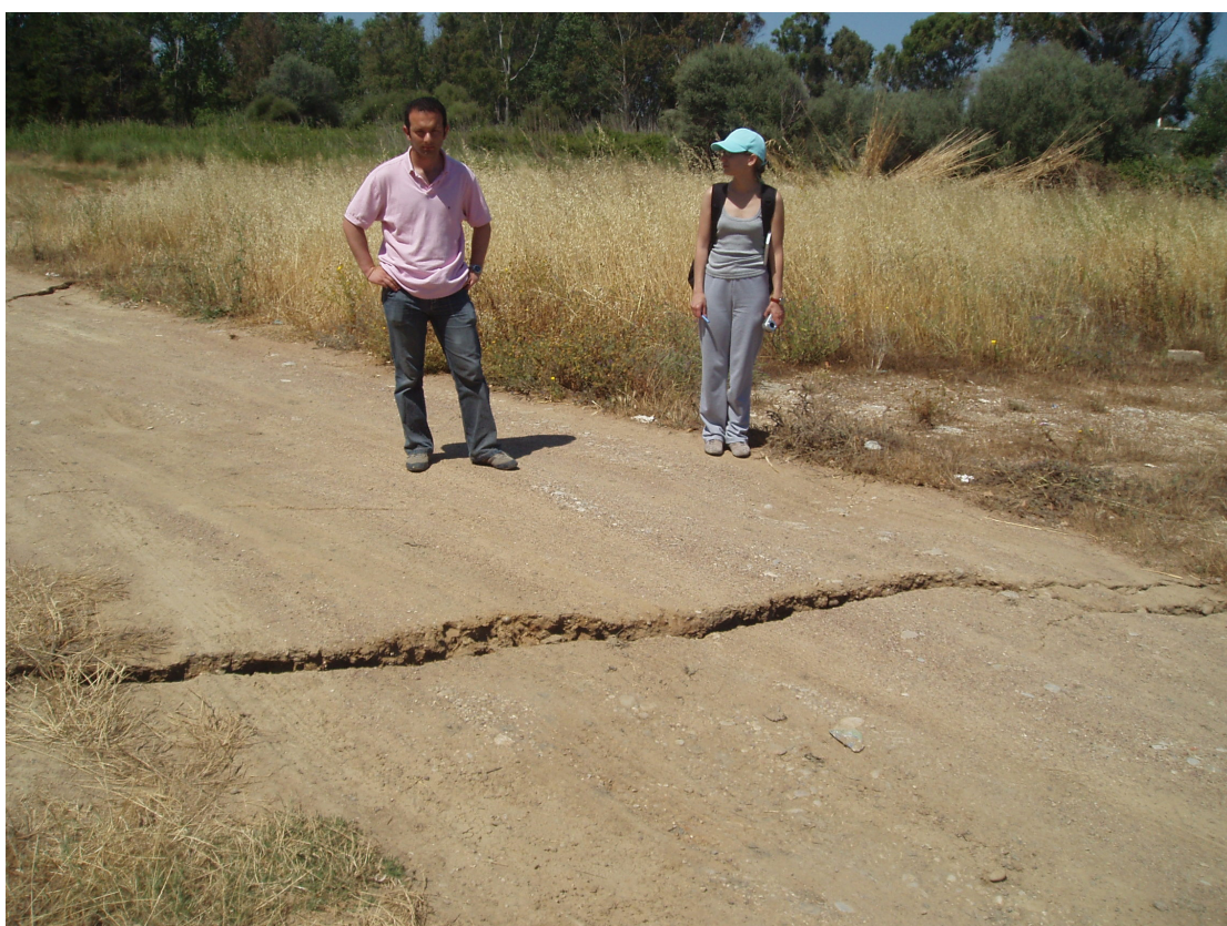
Εικόνα 4. Επιφανειακή διάρρηξη σε οδόστρωμα
