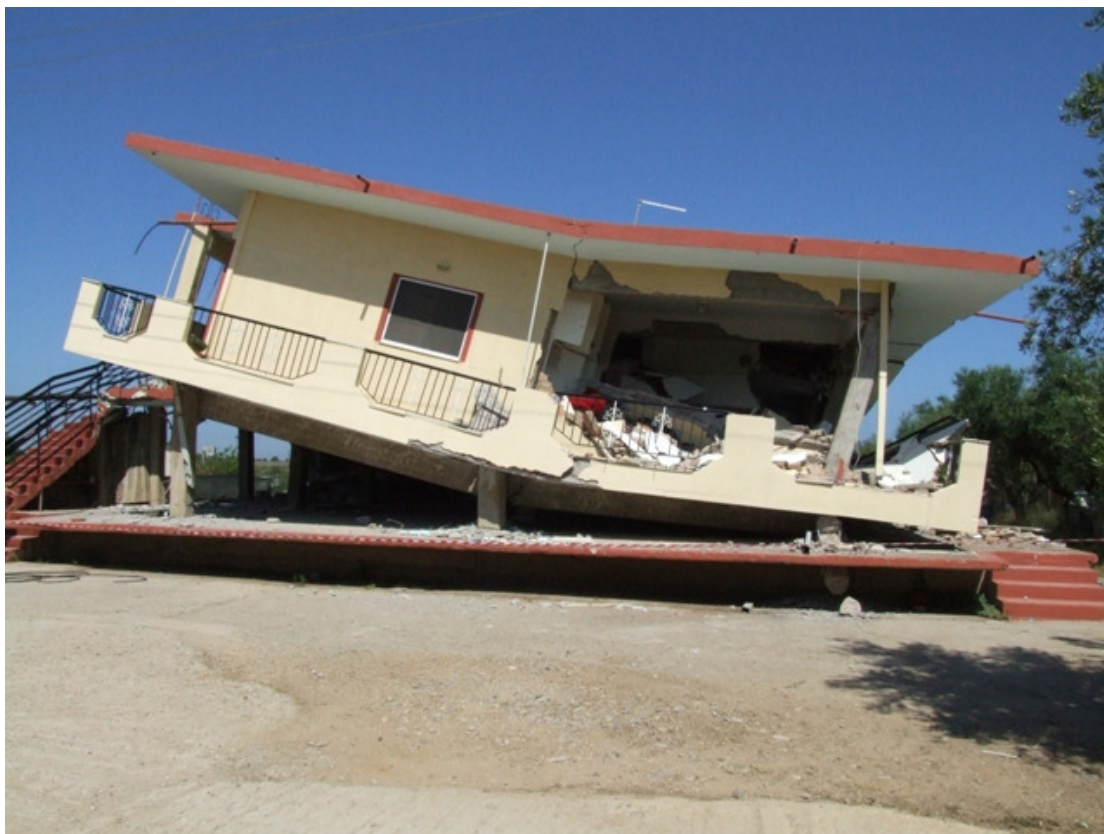
Εικόνα 8. Κατάρρευση κτιρίου Ο/Σ (κατασκευής 1983-1984) λόγω αστοχίας μαλακού ισόγειου ορόφου στα Άνω Διδαχαΐικα
