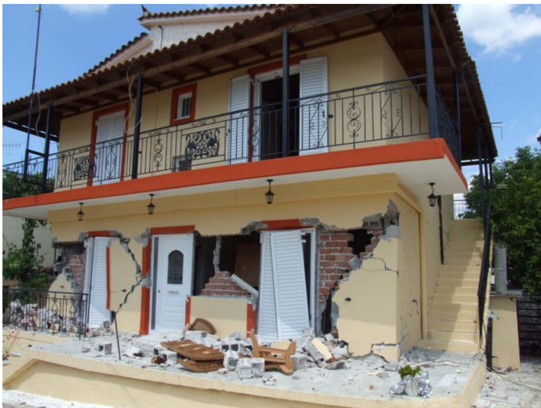
Εικόνα 9. Έντονες βλάβες σε διώροφο κτίριο από φέρουσα τοιχοποιΐα στη Φώσταινα
