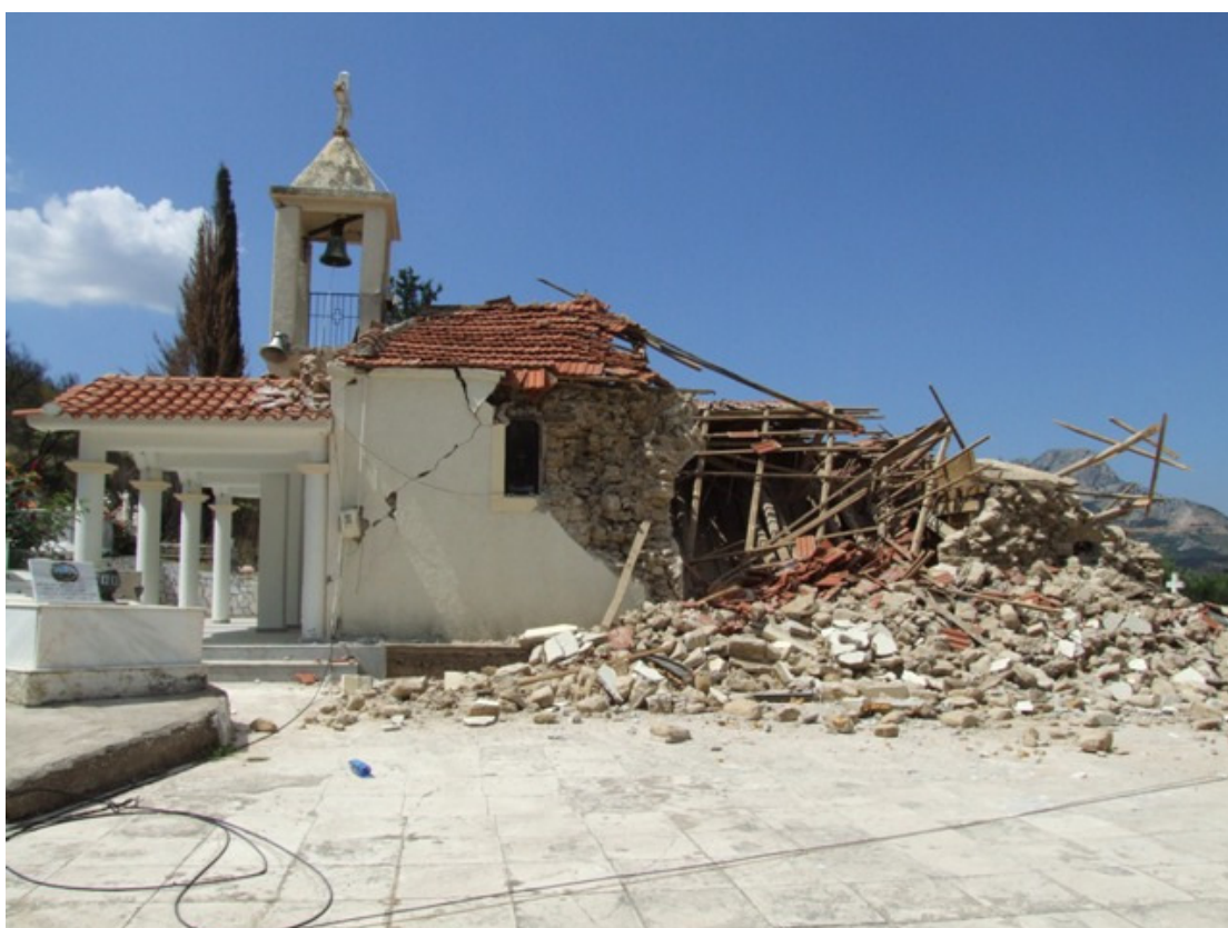
Εικόνα 6. Κατάρρευση ιερού ναού (κατασκευής 1898) στη Βάλμη.
