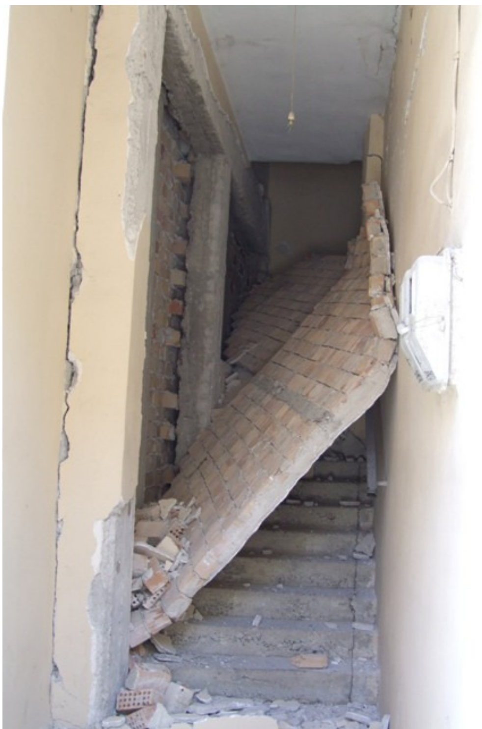
Εικόνα 7. Πτώση τοίχου πλήρωσης που απέκοψε την πρόσβαση σε κλιμακοστάσιο κτιρίου Ο/Σ στο κέντρο του Βαρθολομιού
