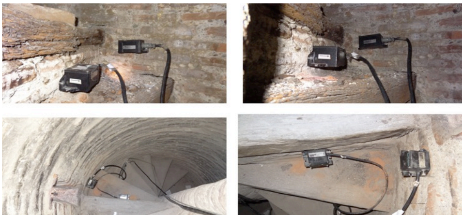
Τοποθέτηση αισθητήρων στον Μιναρέ
