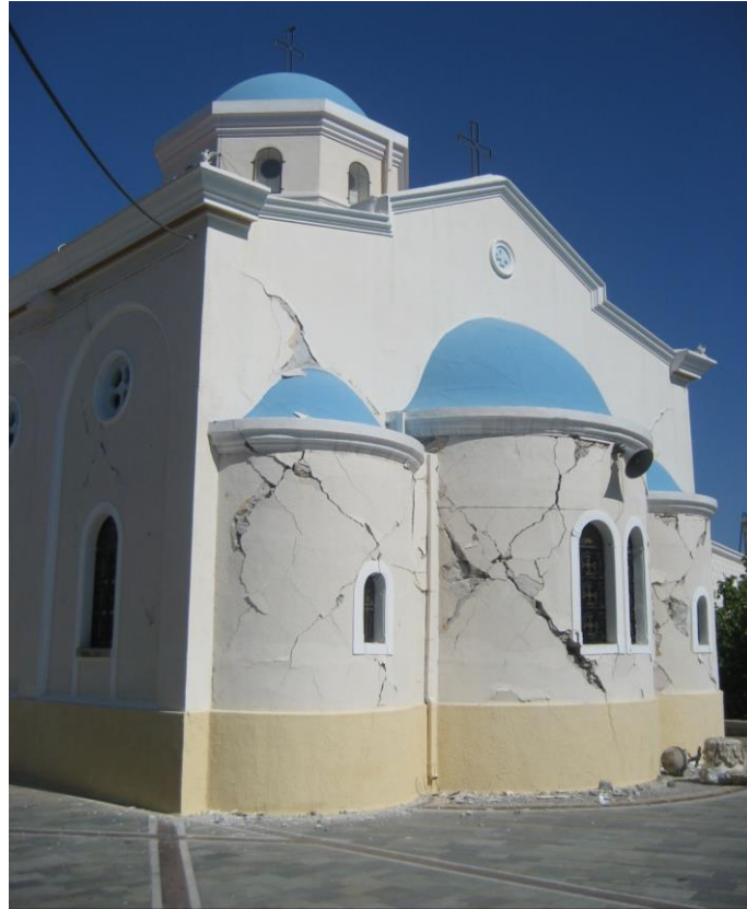
Εικόνα 21. Ρηγματώσεις στην ανατολική λιθοδομή του Ναού της Αγία Παρασκευής στην πόλη της Κω
