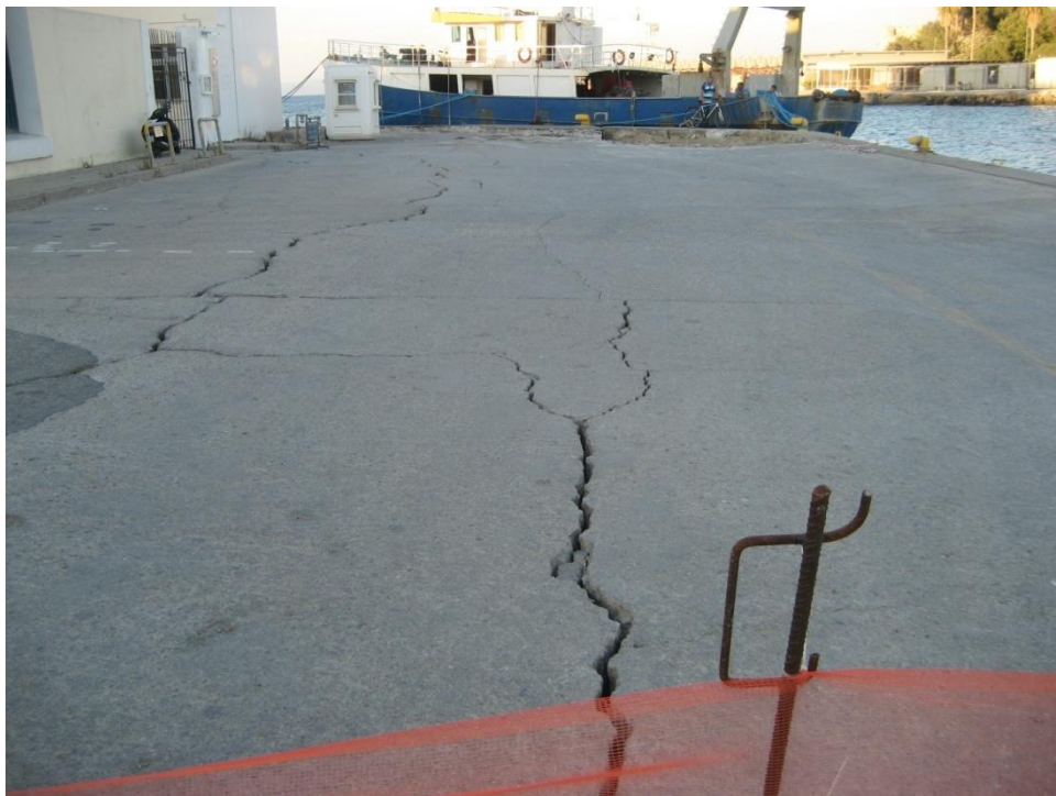
Εικόνα 5. Ρηγματώσεις και καθιζήσεις στην επιβατική - εμπορική αποβάθρα.
