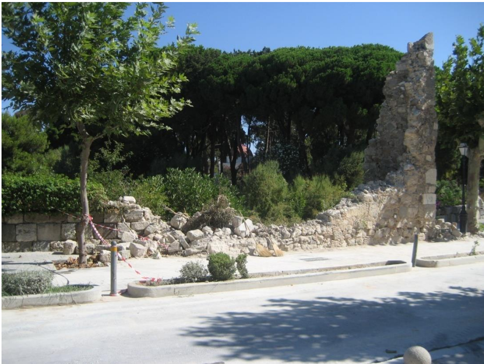
Εικόνες 10. Μερική κατάρρευση λιθοδομής
