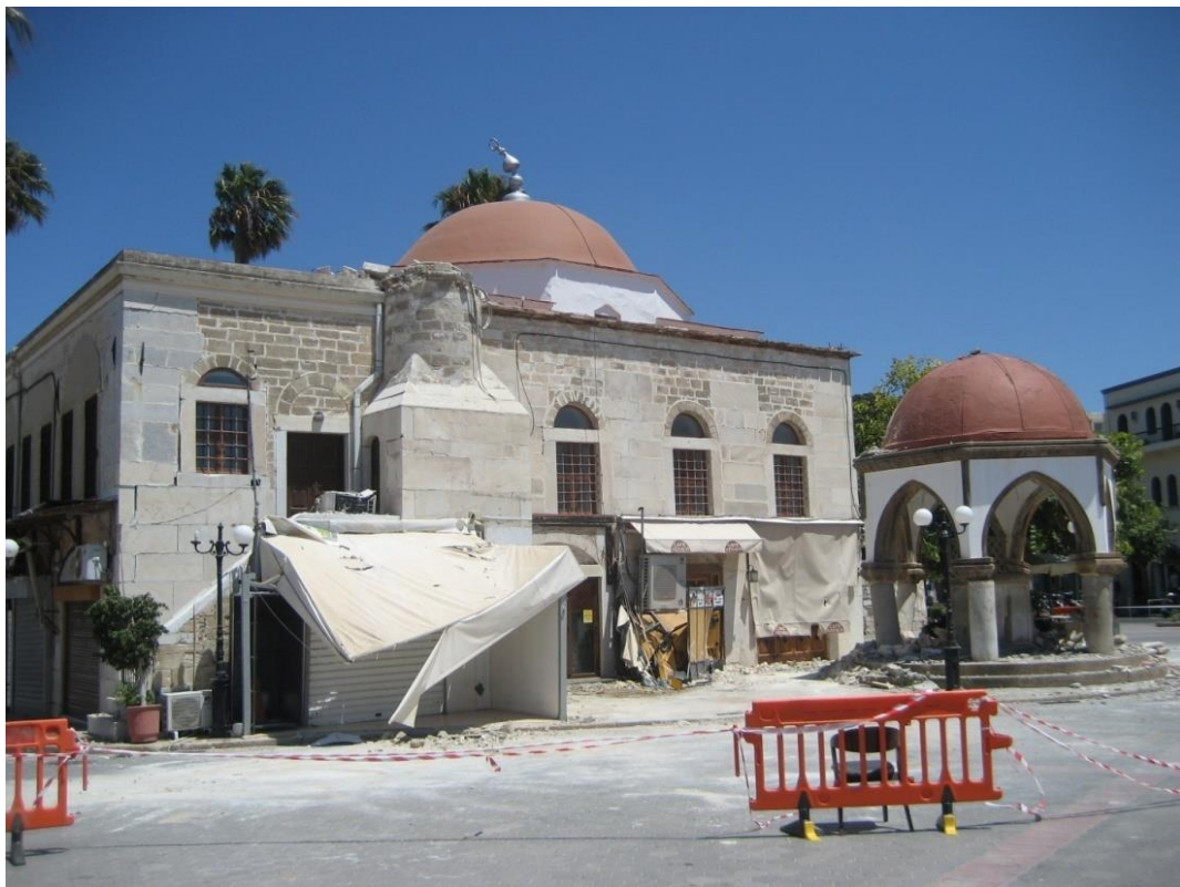
Εικόνες 31, 32. Αστοχία μιναρέ κατά τους σεισμούς 1933 και 2017
