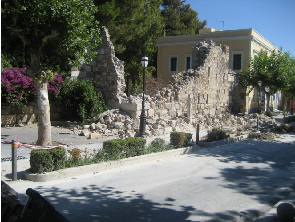
Εικόνα 9.. Μερική κατάρρευση λιθοδομής
