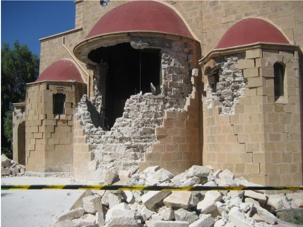
Εικόνα 23. Ναός Αγίου Νικολάου στην πόλη της Κω. Αστοχία ανατολικής λιθοδομής.
