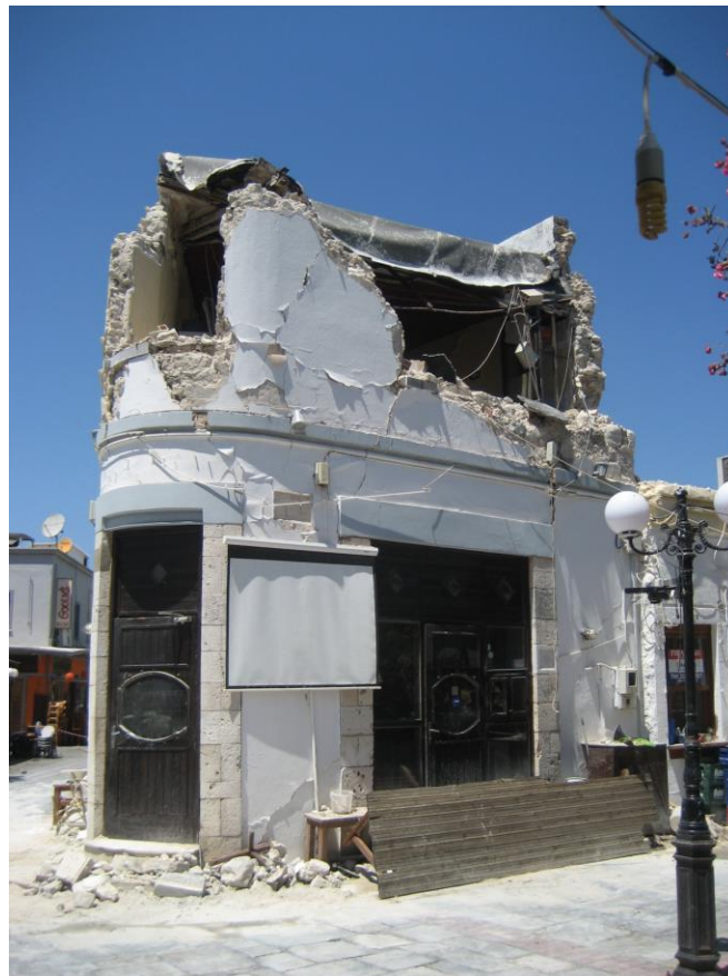
Εικόνες 19, 20. Αστοχία λιθοδομής ορόφου στην περιοχή Εξάρχεια στην πόλη της Κω. Θέση όπου σημειώθηκαν δύο θάνατοι και έξι τραυματισμοί
