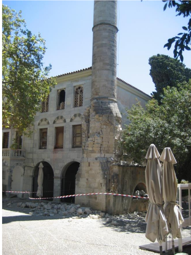
Εικόνα 15. Τοπικές αστοχίες σε μιναρέ στην πλατεία όπου βρίσκεται ο πλάτανος του Ιπποκράτη
