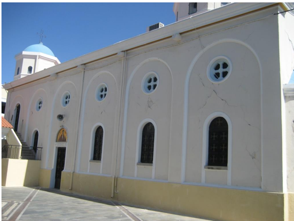
Εικόνα 22. Νότια λιθοδομή του Ναού της Αγίας Παρασκευής. Ρηγματώσεις περιορισμένου εύρους.
