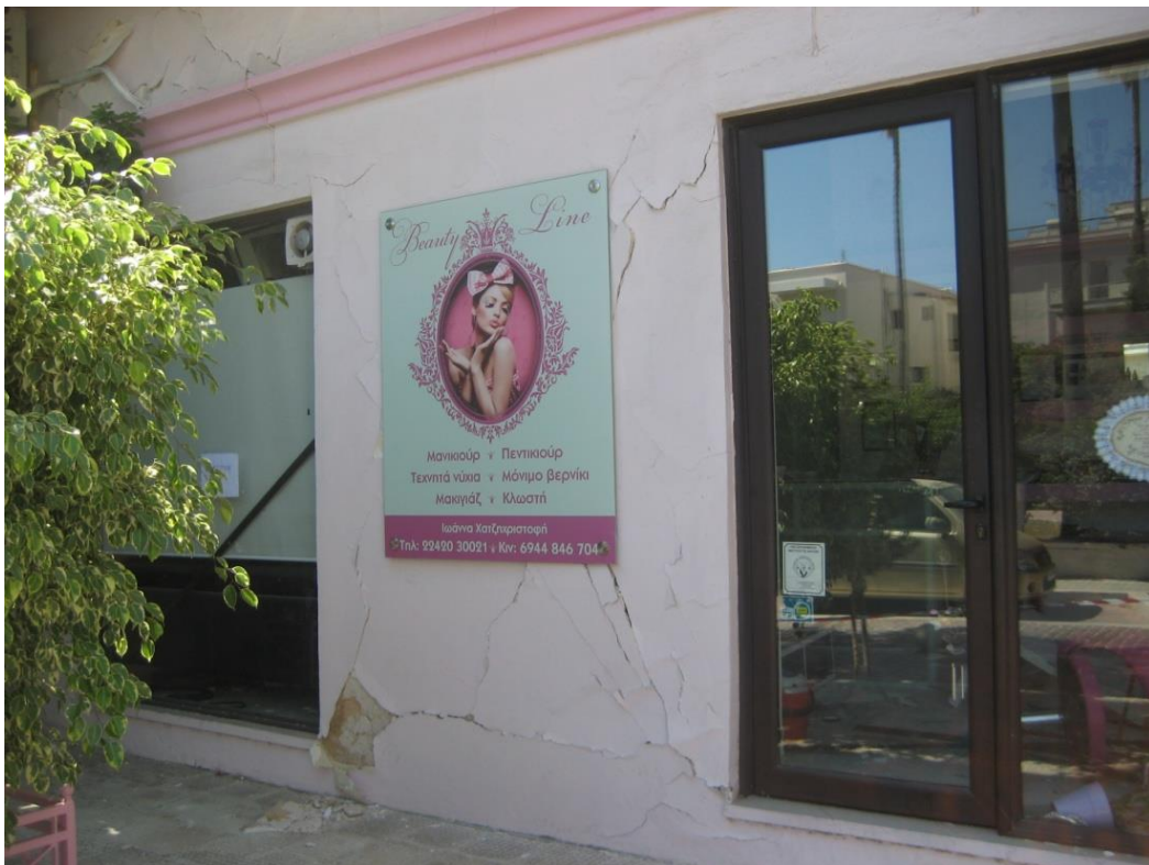
Εικόνες 29, 30. Ρηγματώσεις σε τοιχοποιίες πλήρωσης κτιρίου από οπλισμένο σκυρόδεμα στην πόλη της Κω
