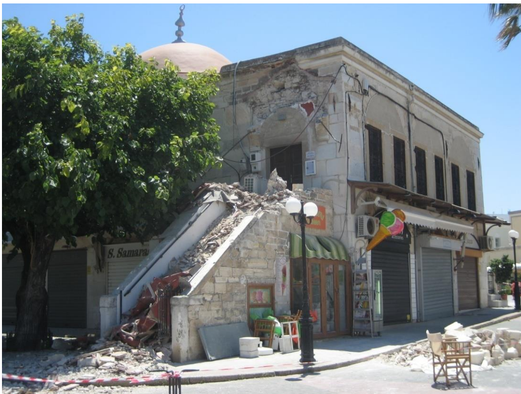
Εικόνα 14. Πίσω όψη τζαμιού με τοπικές αστοχίες
