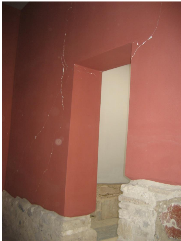
Εικόνα 12. Διάσπαρτες ρηγματώσεις σε φέρουσες λιθοδομές αναστυλωμένου μνημείου (Casa Romana)
