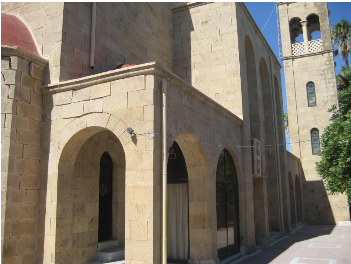
Εικόνα 24. Βόρεια λιθοδομή του ίδιου Ναού. Σημαντικά περιορισμένες βλάβες.
