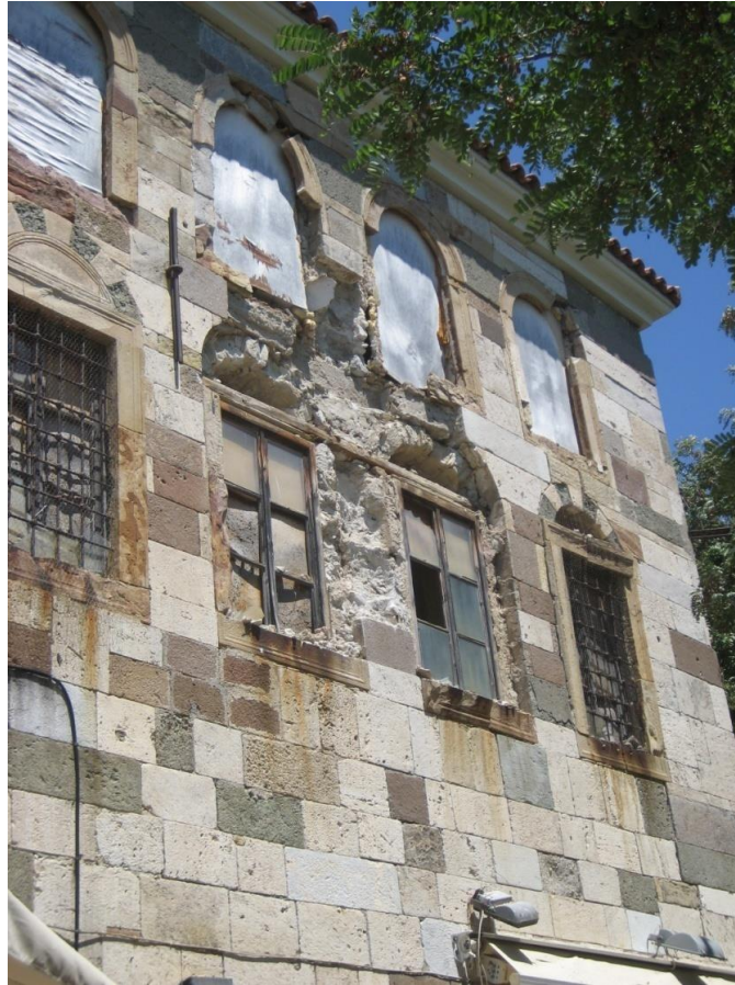
Εικόνα 17. Τοπικές αστοχίες σε λιθοδομή
