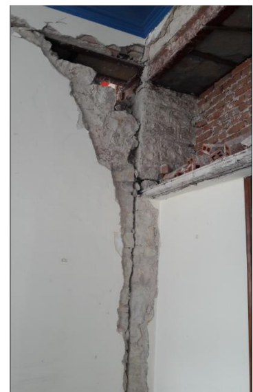
Εικόνα 6. Βλάβες σε τοιχοποιίες και φέροντα στοιχεία κτιρίου κατασκευής 1910 της Μονής Βελλάς (κοντά στο χωριό Καλπάκι)
