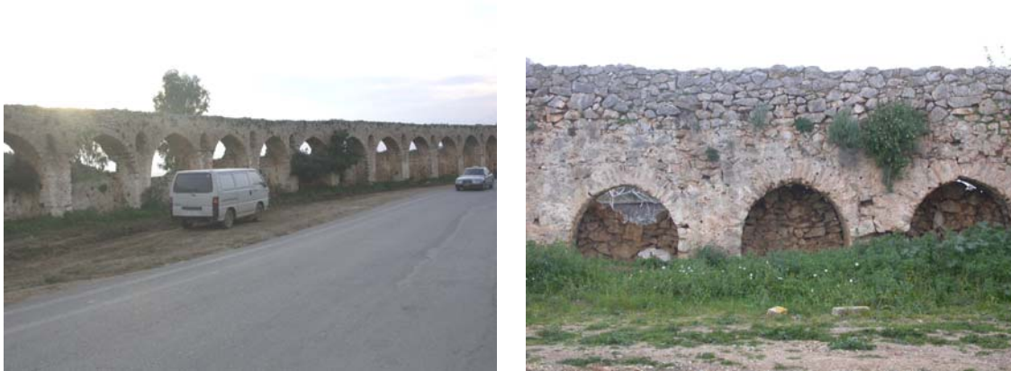
Φωτ. 50,51. Οι ιστορικές καμάρες στην Πύλο, που παρά την υψηλή τρωτότητα που έχουν, δεν παρουσιάστηκαν βλάβες.
