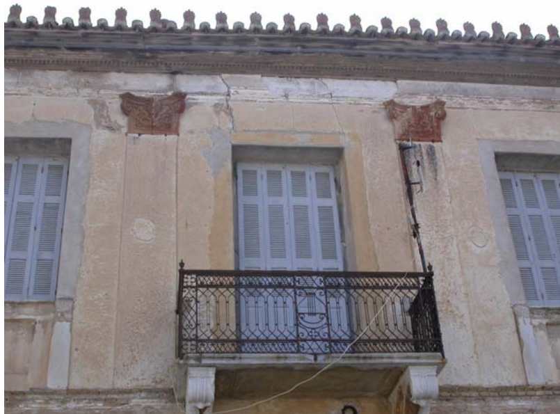
Φωτ.23. Αρχοντικό στην Κορώνη. Ρηγματώσεις υπερθύρων στην τοιχοποιία.
