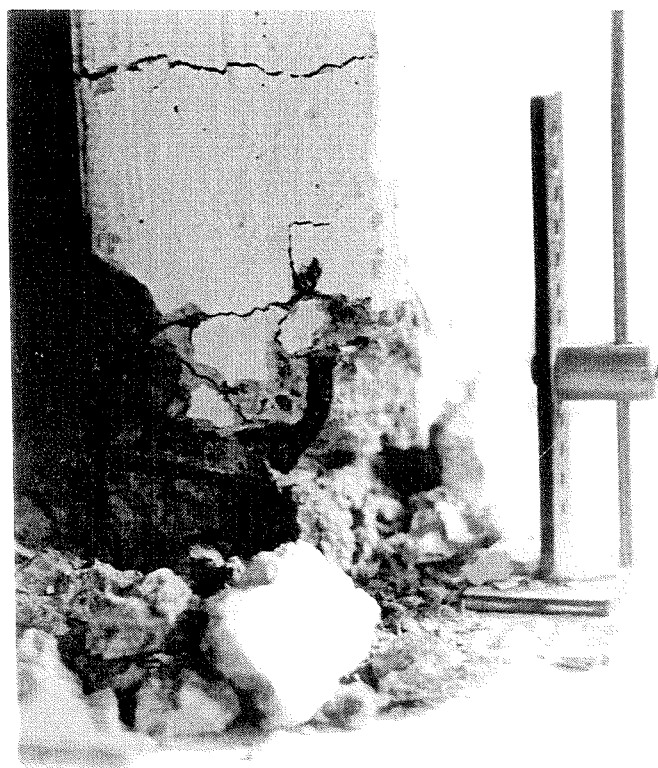
Φωτ. 9. Στο δοκίμιο MSW5 οι ακραίες περισφιγμένες περιοχές καταπονήθηκαν έντονα, σε θλίψη και διάτμηση ή εφελκυσμό, λόγω της υψηλής αντοχής που αναπτύχθηκε με αποτέλεσμα τη συντριβή του σκυροδέματος και το λυγισμό των διαμήκων ράβδων.
